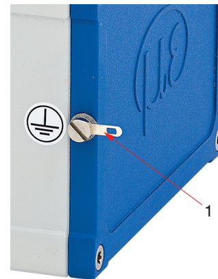
Erdungsanschluss am Gehäusedeckel (1)
